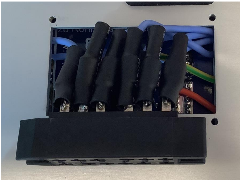
Abbildung 13: Verkabelung Anschlussbox Frontplatte
